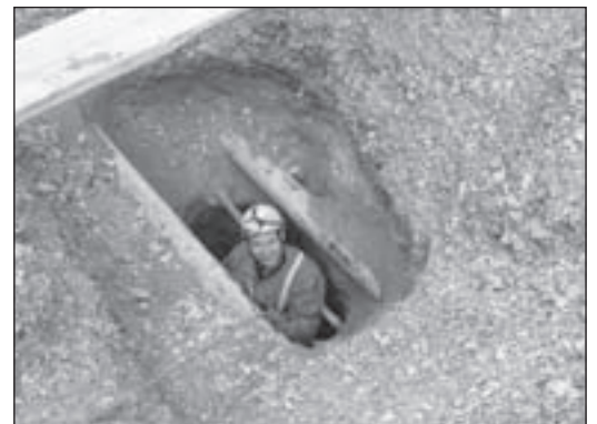
Orifice d'un des gouffres s'étant ouverts lors de travaux en pleine ville de La Chaux-de-Fonds.
