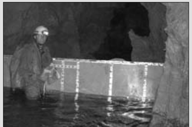
L'un des déshuileurs installés sur le cours de la rivière souterraine de Milandre.
