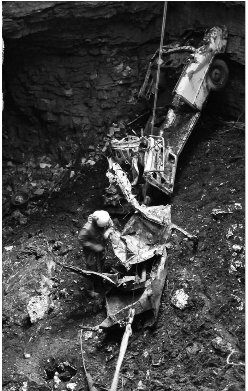
Aushub eines Autowracks im Creux Boillet (Provence, VD) anlässlich der Sanierungsaktion im Jahr 2012.
