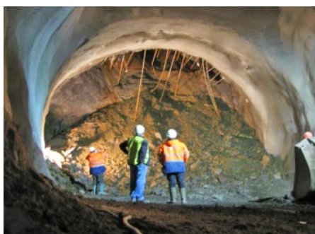
Karsthohlräume verursachen Probleme beim Tunnelbau.
