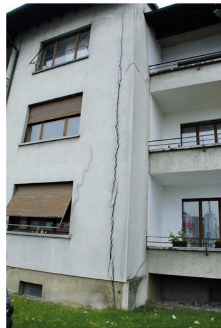
Riss an einem Gebäude, der durch langsames Absinken des Bodens verursacht wurde (Basel-Landschaft).
