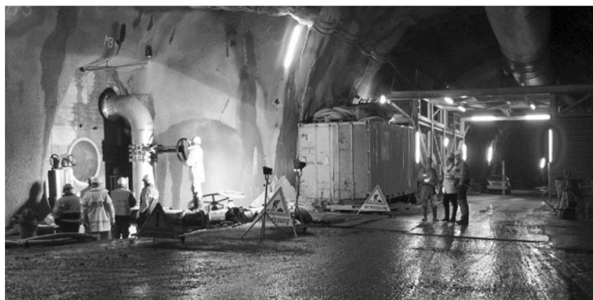
Ci-dessous, le barrage (sur la gauche de l'image) construit dans le tunnel.
