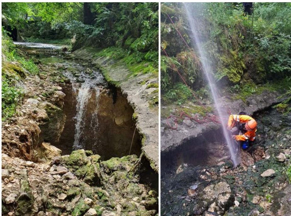
Cavité ouverte en été 2023 en aval de la station d'épuration de La Chaux-de-Fonds, après un événement de crue. Une conduite d'eau a été rompue.
